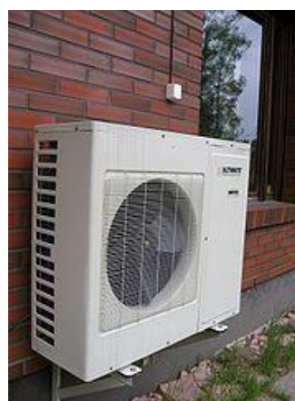
Acondicionador de aire por bomba de calor.
